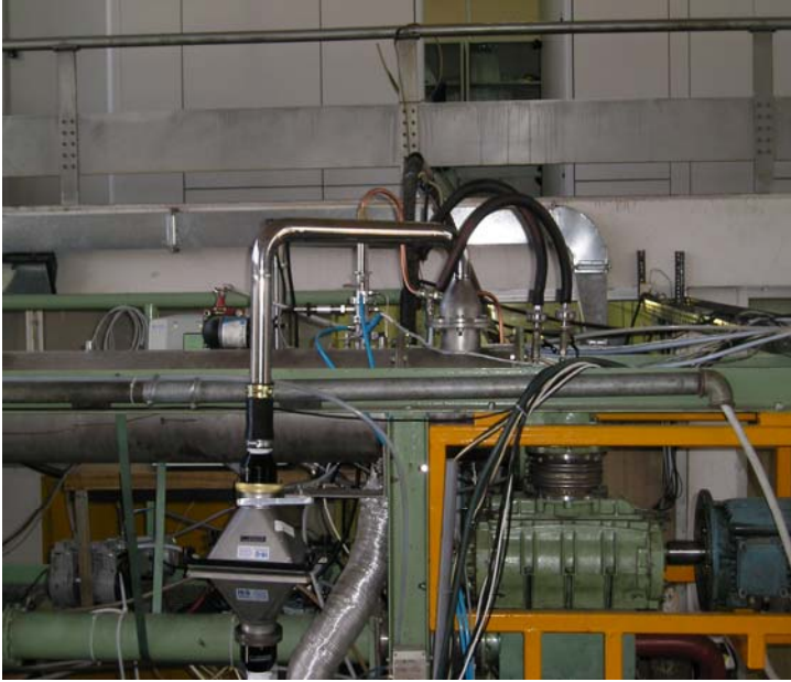
Εικόνα Γ. Εγκατάσταση δειγματολήπτη μεγάλου όγκου
