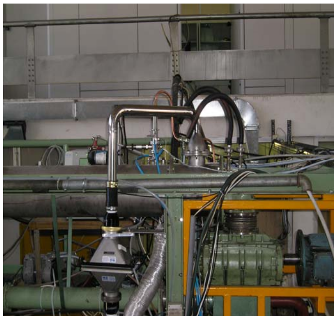
Εικόνα 24. Εγκατάσταση δειγματολήπτη μεγάλου όγκου
